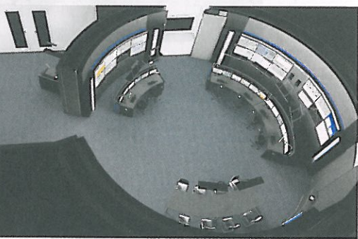
Das Fachpersonal von JST installierte innerhalb von vier Wochen die eigentliche Leitwarte inklusive separatem Vorraum für die Energie-Arbeitsplätze und richtete auch einen Multifunktionsraum mit proaktiver Monitorwand sowie einen Technikraum ein.
