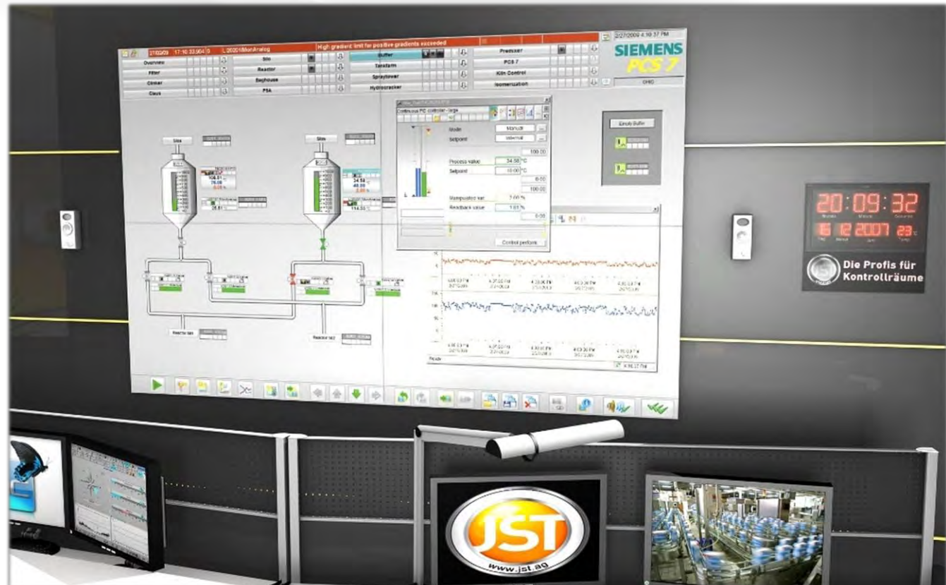
Video-Wall, bestehend aus 4 Stück LED-Cube60 in der Anordnung 2 x 2; eingefasst in einer Großbildwandverkleidung mit Design-Streifen
