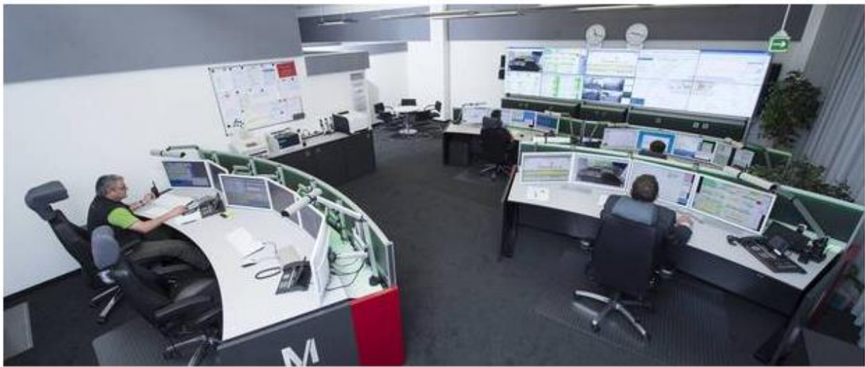
Die modernisierte Leitwarte Technik des Münchner Flughafens. (Quelle: Jungmann Systemtechnik)
