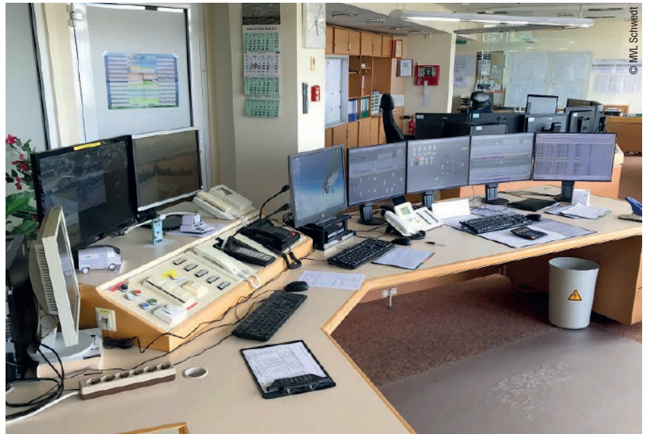
Abb. 2: Bis vor kurzem waren die Operatoren in dieser 20 Jahre alten Leitwarte untergebracht. Zuletzt gab es pro Arbeitsplatz acht Bildschirme, um die steigenden Aufgaben der Leitwarte zu bewältigen.
