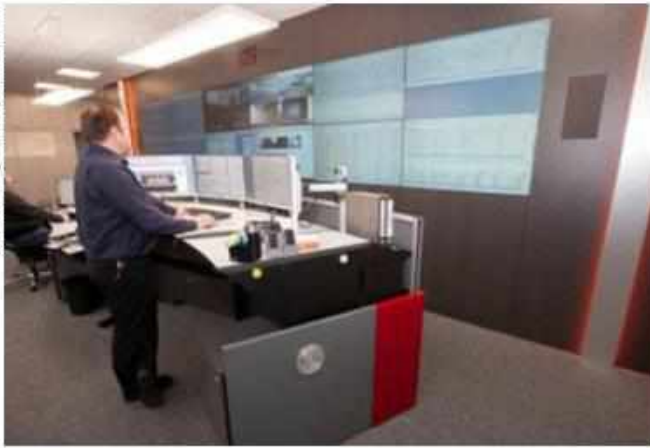
Bild 3: Die vorhandenen Arbeitsplätze verfügen über stabile Stratos X11-Kontrollraumpulte, die speziell für den 24/7-Schichtbetrieb konstruiert und in der Höhe elektromotorisch einstellbar sind.
