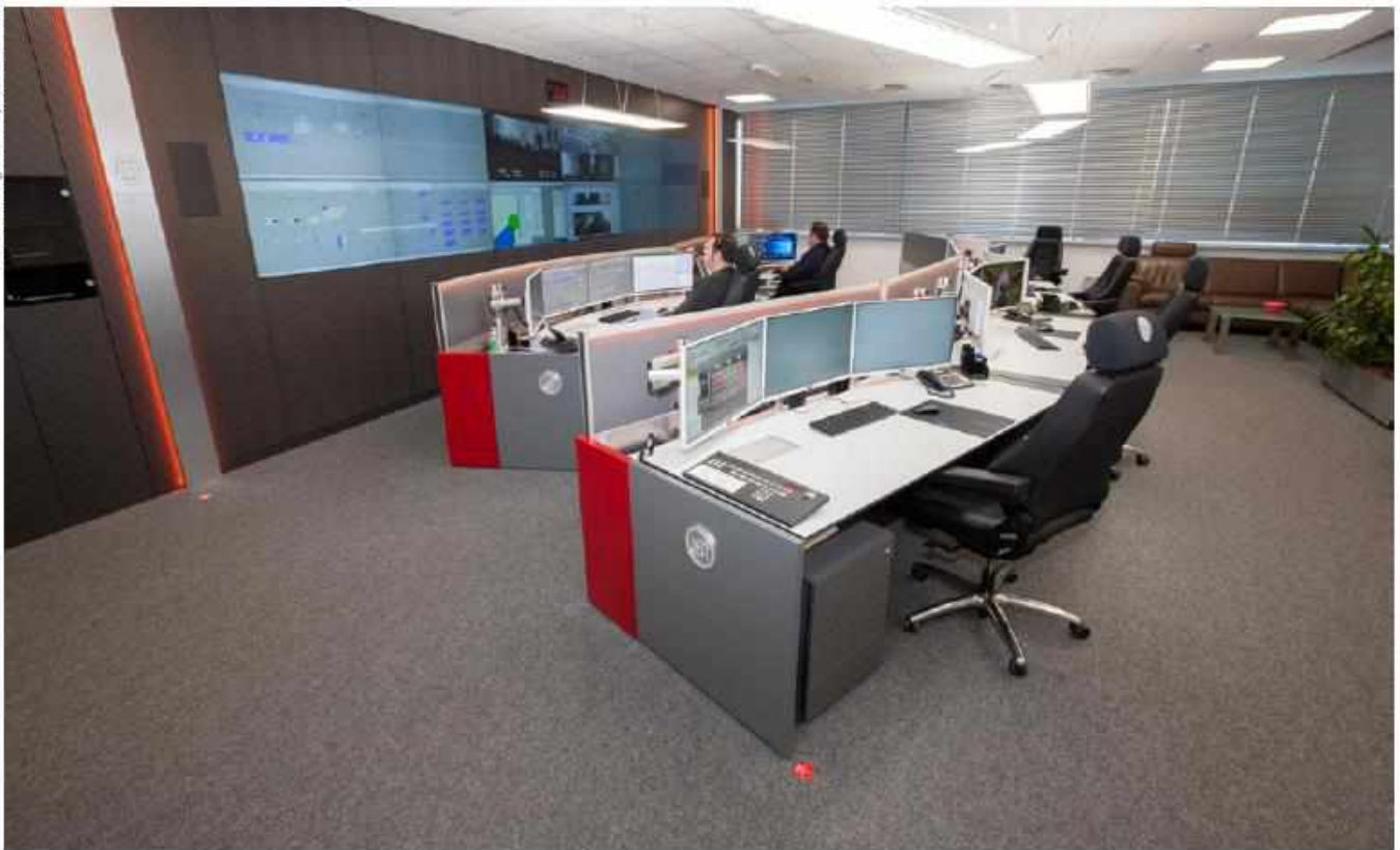
Bild 2: Nach der völligen Neugestaltung durch die Leitwartenexperten von JST aus Buxtehude gibt es nun insgesamt zwölf Arbeitsplätze, die auf unterschiedliche, neu konzipierte Räume verteilt sind. Sechs davon befinden sich im eigentlichen Wartenraum.
