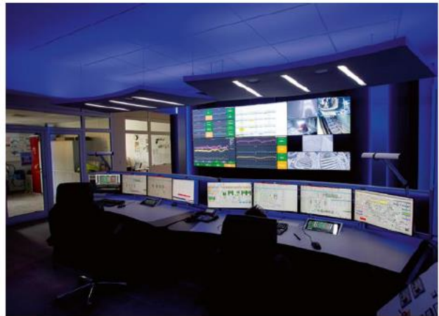
Bild 3 Für eine konstant hohe Produktqualität sorgt heute ein moderner Kontrollraum, der alle Anlagenteile und Herstellungsprozesse überwacht. (© Jungmann Systemtechnik)
