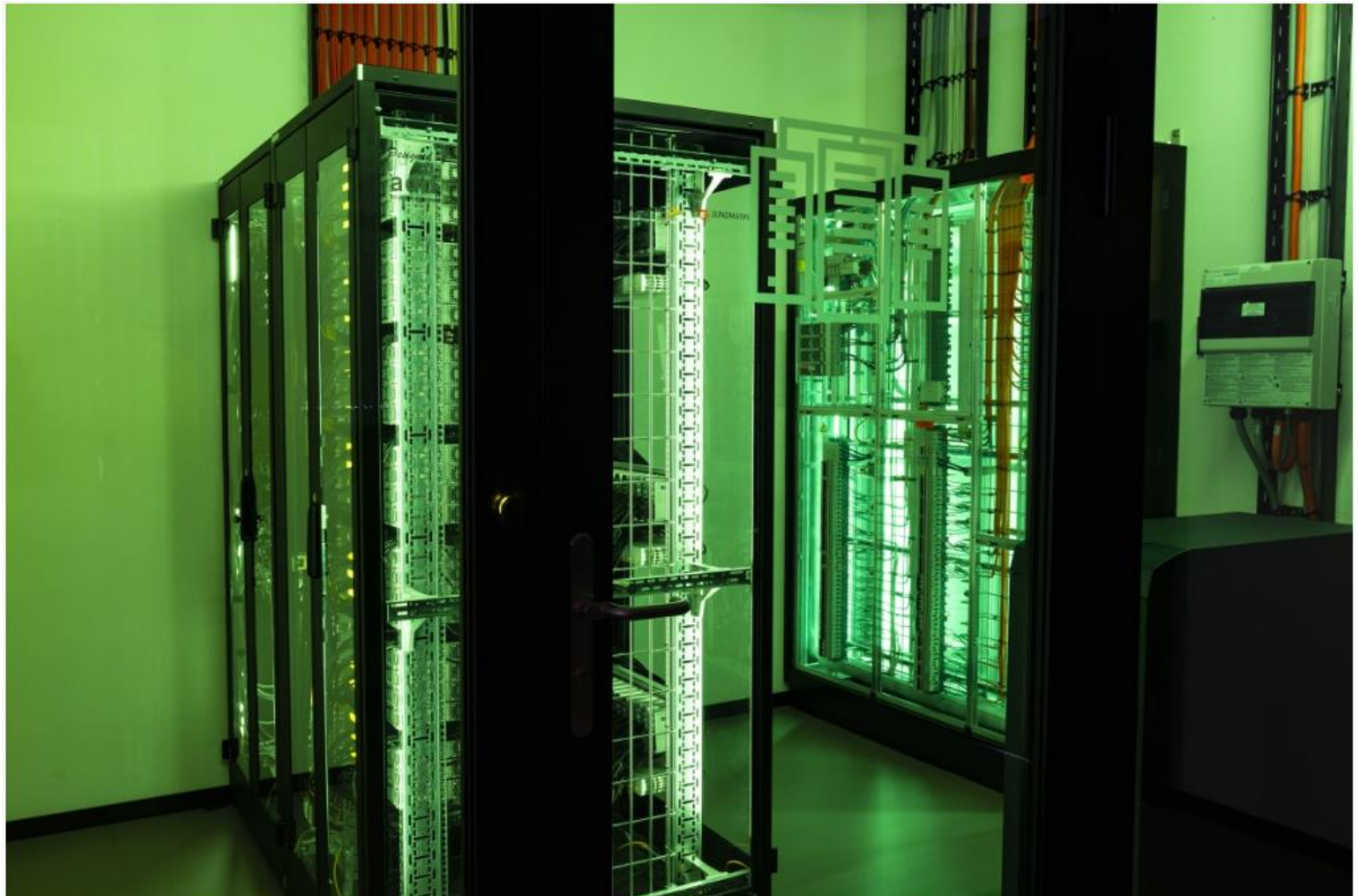
Durch die Reduktion notwendiger Rechner und physischen Server sowie das Bündeln in effizienten HCI-Clustern kann die Hardware wirkungsvoller ausgelastet werden Bilder: JST Jungmann Systemtechnik GmbH
