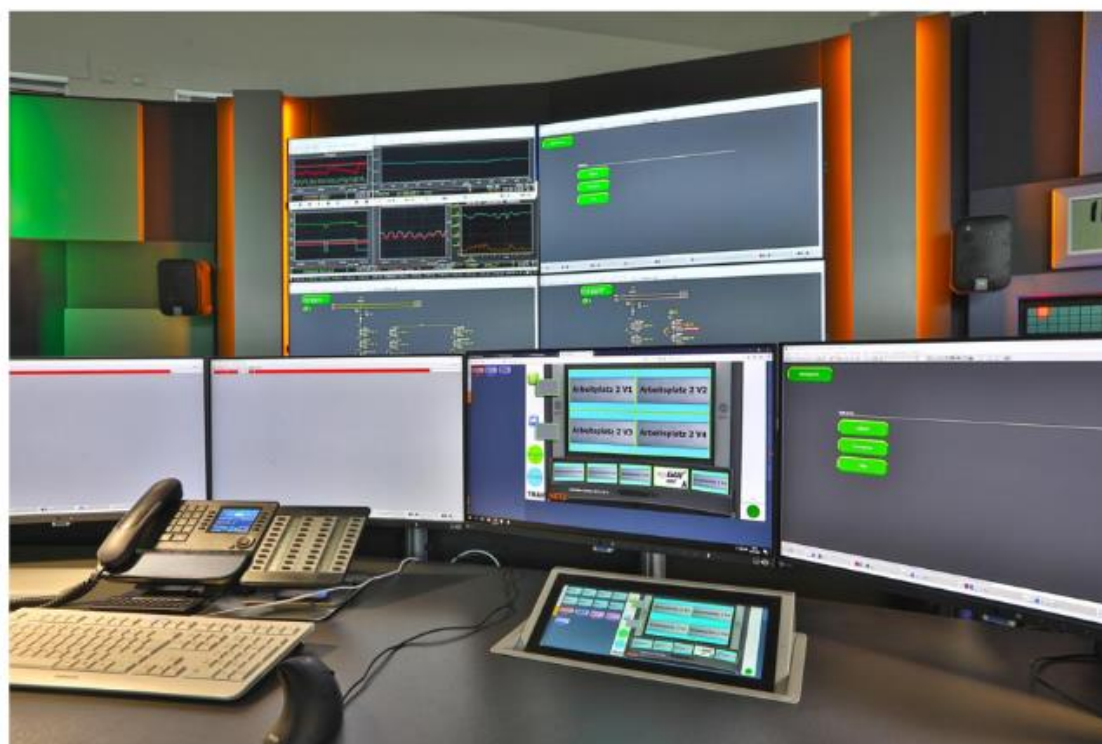
Das gesamte System lässt sich über die intuitive Mygui-Oberfläche einfach bedienen und erlaubt eine flexible Anzeige sämtlicher Systeme der Netzleitstelle.
