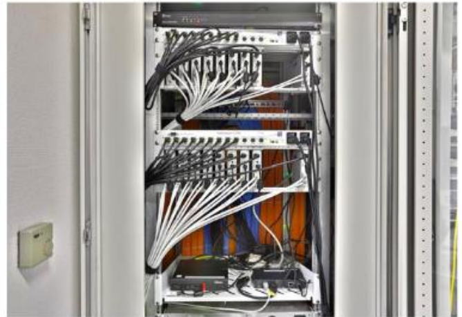
Beim Ausfall einer Systembaugruppe übernimmt augenblicklich ein zweites Cluster deren Funktionen.
