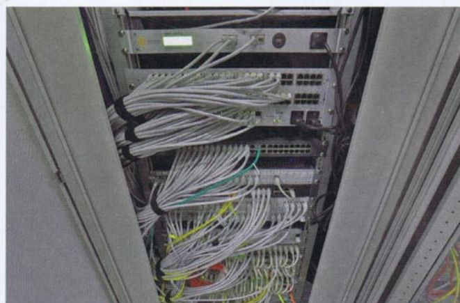
Bild 3: Aufgrund der KRITIS-Klassifikation des Standorts sind die einzelnen Systeme redundant ausgelegt.
