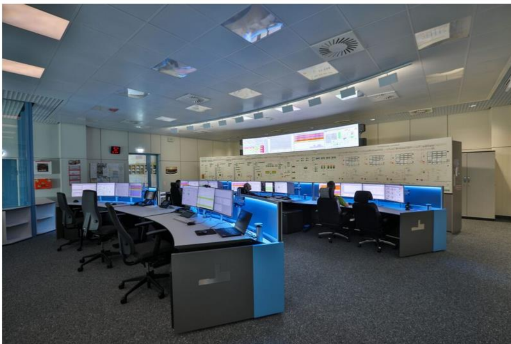
Nach der Modernisierung wird die Überwachung der Kraftwerksprozesse durch Großbildwände und intuitive Steuerungslösungen unterstützt. (Bild: Jungmann Systemtechnik GmbH & Co. KG)
