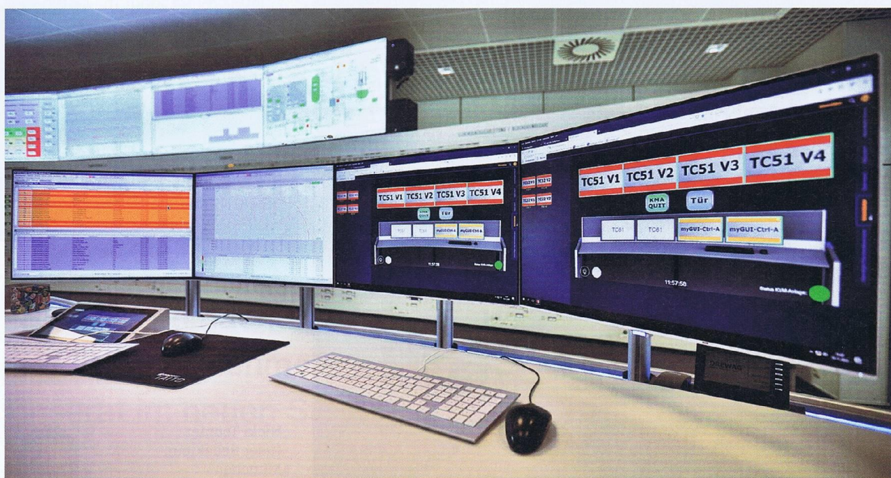
Bild 2. Durch das Multi-Consoling-Konzept lassen sich alle Rechner-, Kamera-, System- und Sensordaten aus den angeschlossenen PC und Datenpunkten des Heizkraftwerks sowohl an den Operator-Plätzen als auch auf den Video-walls aufrufen
