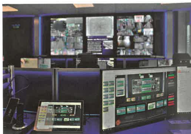
Die interaktive myGUI-Bedienoberfläche stellt Monitore und Großbildwand als 3D-Kontrollraumbild dar. Über ein separates Tablet als zentrale Schaltstelle greifen die Mitarbeiter sicher und komfortabel auf alle benötigten Quellen zu.
