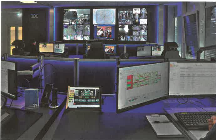
JST installierte in der neuen Sicherheitsleitwarte die KVM-Technologie MultiConsoling, mit der auf der Display Wall und den Arbeitsplatzmonitoren flexibel verschiedene Systeme, Daten oder Kameras aufgerufen werden können. Rund 20 verschiedene Quellen, darunter Kamerabilder, Kommunikations- und Dispositionssysteme, lassen sich bedarfsgerecht auf einzelne Monitore oder auf die Videowall schalten.
