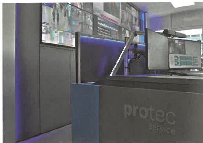
Die tiefergelegten Monitorstellflächen der Kontrollraumpulte sorgen für einen freien Blick auf die Videowall und erleichtern die Kommunikation mit den Kollegen. Zudem lassen sich die Monitore individuell einstellen und über bewegliche 3D-Gelenkarme parabolisch anordnen.
