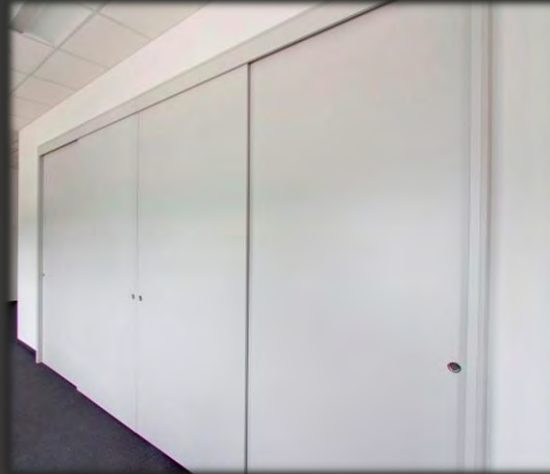
Detailansicht: Schiebetüren auf der Rückseite der Großbildwand-Verkleidung als Raum-in-Raum-Funktion.
