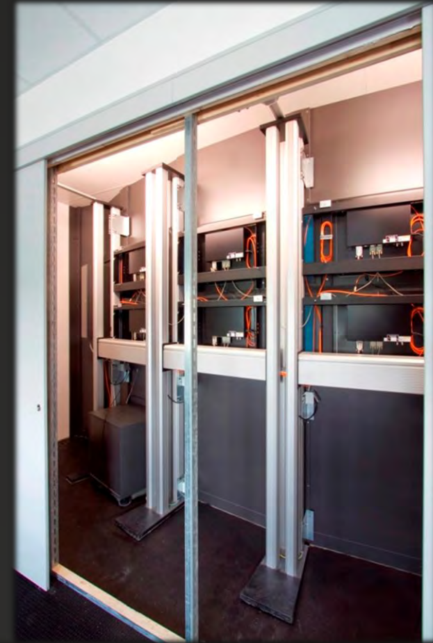
Detailansicht: Hinter den Schiebetüren befinden sich die stabilen JST-Racks zur Aufnahme der LC-Displays.
