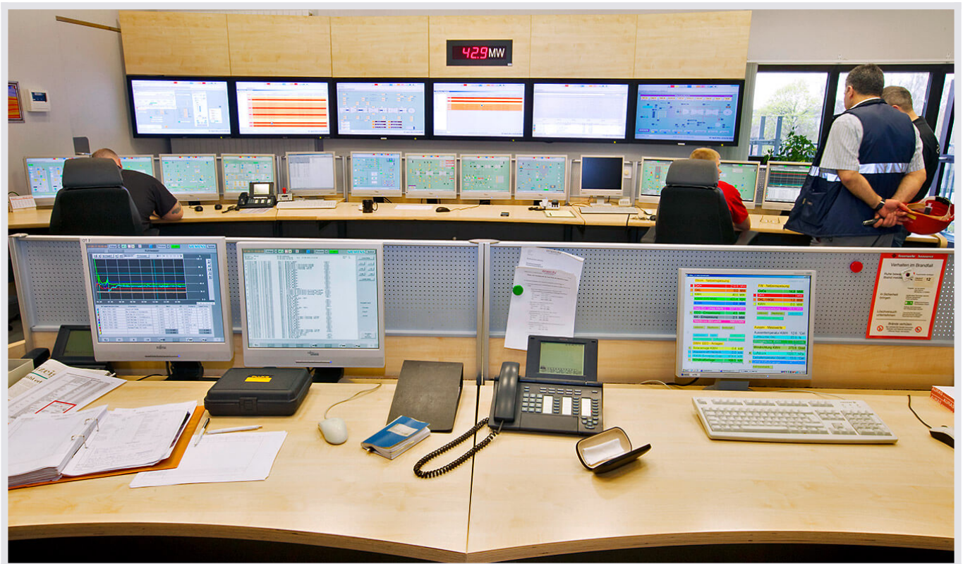
Stadtwerke Hannover - modernisierte Blockwarte
