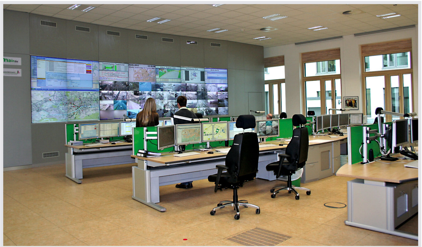
Straßenverkehrsamt Frankfurt am Main: neue integrierte Gesamtverkehrsleitzentrale
