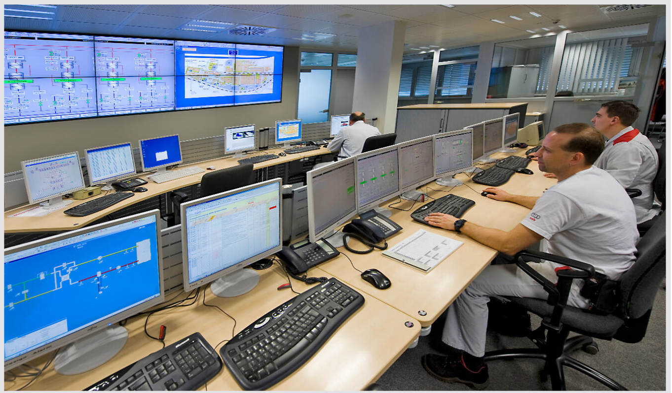
Audi Neckarsulm: Zentrale Leitwarte saniert
