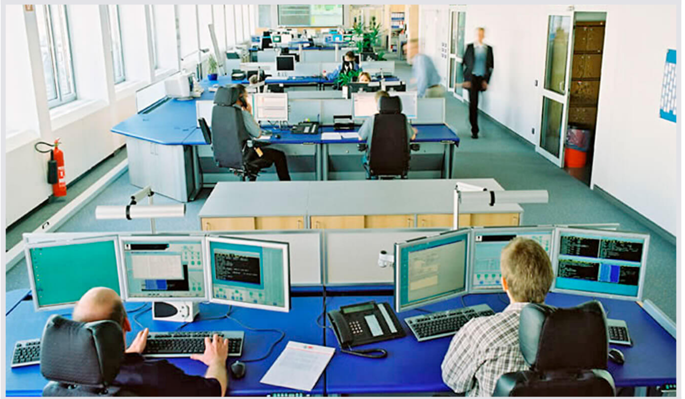
Lufthansa Systems Rechenzentrum. Operator-Plätze.
